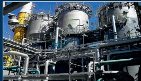
Absorber, Prozessbecken und Rohrleitungen werden z.B. in der NE-Metallgewinnung und in Säureproduktionsanlagen gummiert und zusätzlich ausgemauert.
