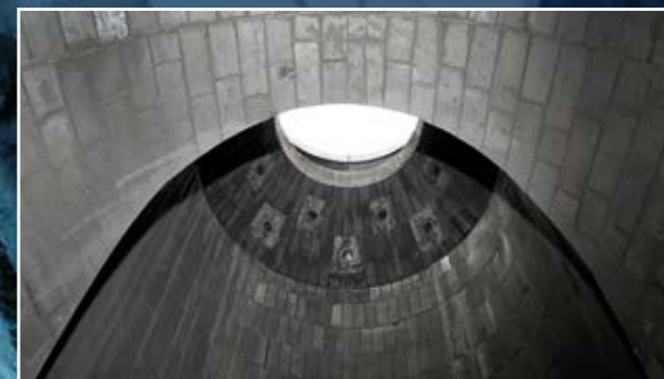
Systemauskleidung mit Kohlenstoffsteinen.
