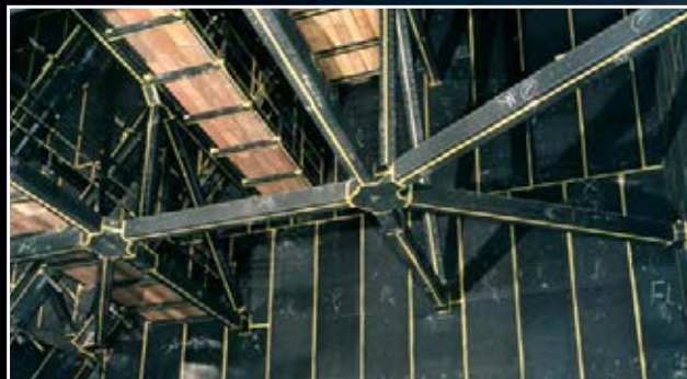
Gummierung in einem Rauchgaswäscher.
