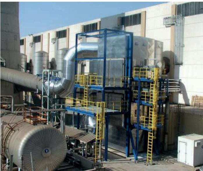
DeNOx-Anlage zur Reduzierung der Stickstoffoxide (NOx) aus den Abgasen von Schweröldieseln
