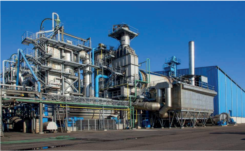
Komplette Rauchgasreinigungsanlage nach einer Sondermüllverbrennungsanlage mit Abhitzeessel und Dampfturbine
