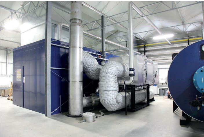
ECO2PRO-Anlage in einem Treibhaus
